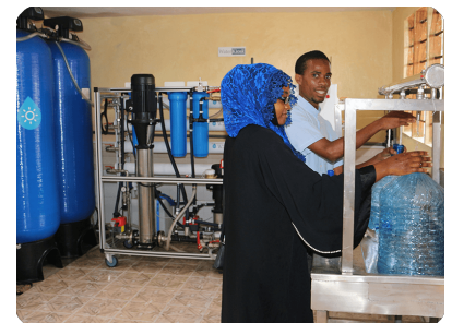
Solarbetriebene Wasseraufbereitung in Kenia
